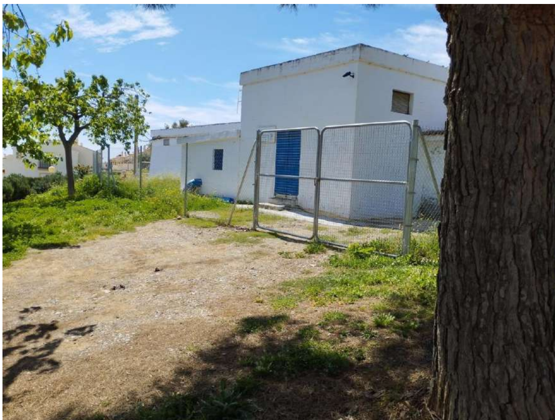
Entre las actuaciones se mejorará el contador de salida del depósito Torre del Mar.
